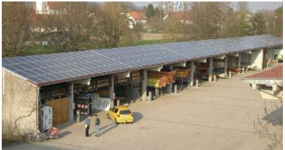
Solaranlage auf dem Landkreis-Bauhof
