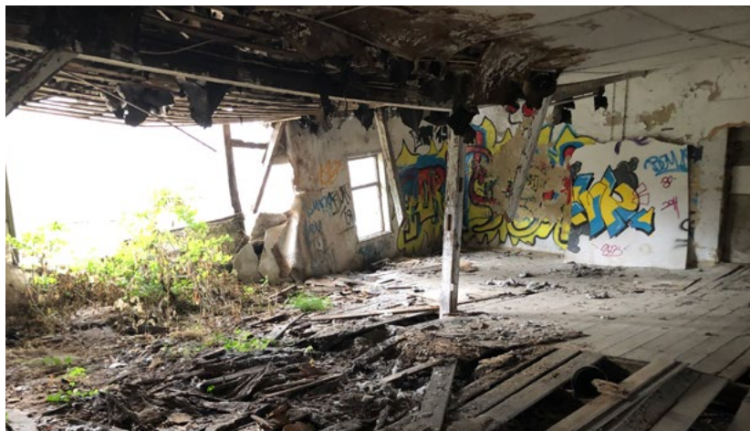
Moosburg, Sabathielbaracke: Blick auf die zu stützenden Dachbalken
