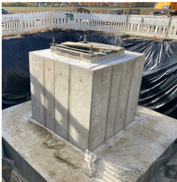
Teile des Bodendenkmals sind beim Betonieren des Mastfundaments zerstört worden. (Foto: Kreisarchäologie Freising)
