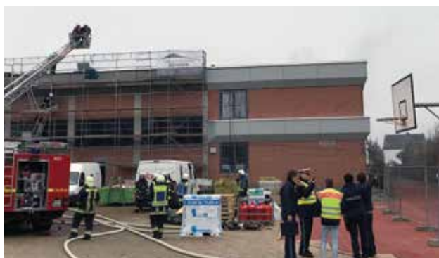
Im Laufe der Dachsanierung am Gymnasium Moosburg musste wegen eines Brandes die Feuerwehr anrücken.
