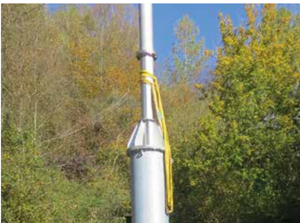
Die neue Gasfackel an der Mülldeponie Marchenbach.
