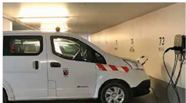
In der Tiefgarage steht eine Elektroladestation bereit.
